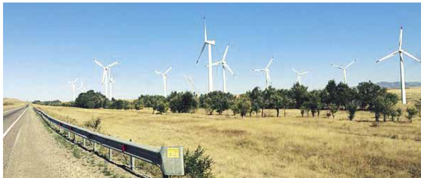
Рис. 102. Ветровые электроустановки в Жамбылской области
